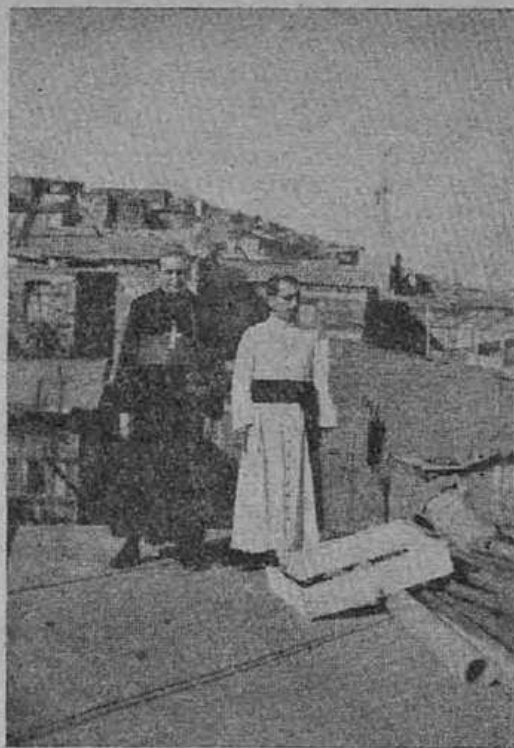
Mons. Estevão Corradi, visitando as obras do Templo Nacional, em Caracas, na companhia do Padre Nuñez, Vigário Geral do Patriarca de Caracas, na Venezuela.
